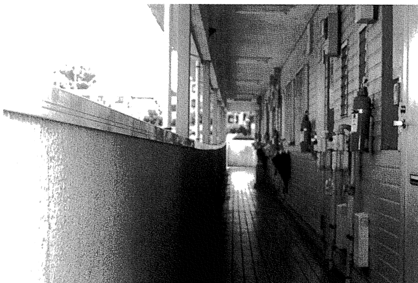
① 圧密沈下による不具合の例
