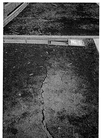
② 即時沈下による不具合の例
